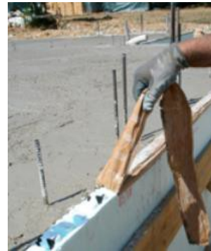
Figure 12 : Protection du panneau extérieur lors du coulage de la dalle de compression du plancher
